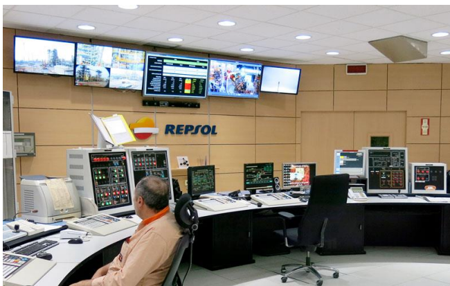
Sala 24 h en la Refinería de la planta de Tarragona de Repsol
